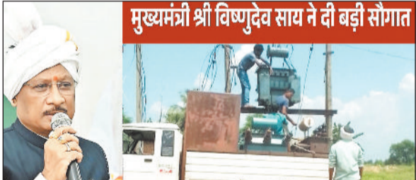
क्षेत्र में एक और बड़ी उपलब्धि हासिल हुई है। 400 केवी उपकेंद्र कुनकुरी के हरांडंड में प्रदेश का 5वां सबसे बड़ा 400/220 केवी का अत्याधुनिक उपकेंद्र स्थापित किया जा रहा है। साथ ही नए सब-स्टेशन (33/11 KV): ये सब-स्टेशन सलिहाटोली, विपतपुर, भगोरा, समडमा, मैनी, रेडे, पालीडीह, खुट्टरा एवं चेटवा सहित अन्य स्थानों पर निर्मित किए जाएंगे एवं उच्च क्षमता केंद्र- फरसाबहार और झिक्की बगीचा में 132/33 केवी के सब-स्टेशन स्वीकृत हैं। इन योजनाओं के लागू होने से बिजली की गुणवत्ता में सुधार होगा साथ ही लो वोल्टेज और ट्रिपिंग की समस्या कायों को गति मिलेगी तथा ग्रामीण जीवन स्तर में सुधार आएगा, विद्युत विभाग में बड़ी सौगत मिलने के बाद जिले भर में खुशी का माहौल है। स्थानीय लोगों ने मुख्यमंत्री विष्णुदेव साय का आभार व्यक्त करते हुए इसे क्षेत्र के विकास की दिशा में एक बड़ा कदम बताया है।
